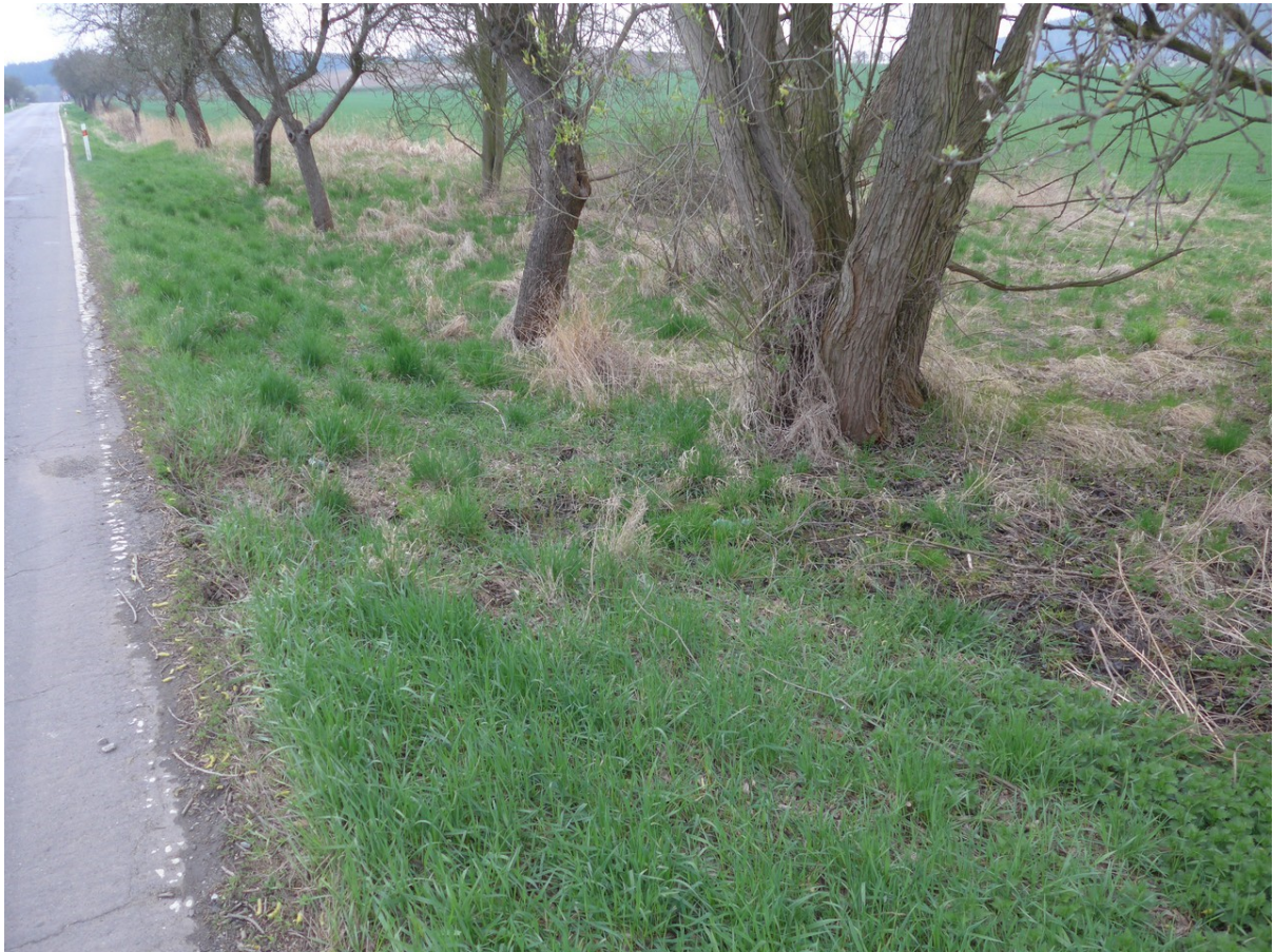
Pohled na prostor, kde se nachází nefunkční propustek (TB P.B)
